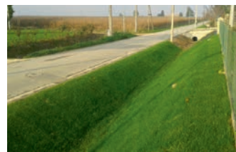
Sator zur Begrünung eines Entwässerungsgrabens
