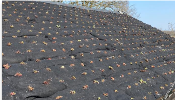
Nach Installation | Wichmond, NL
