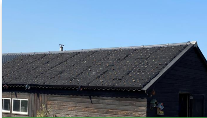
Nach Installation | Wichmond, NL
